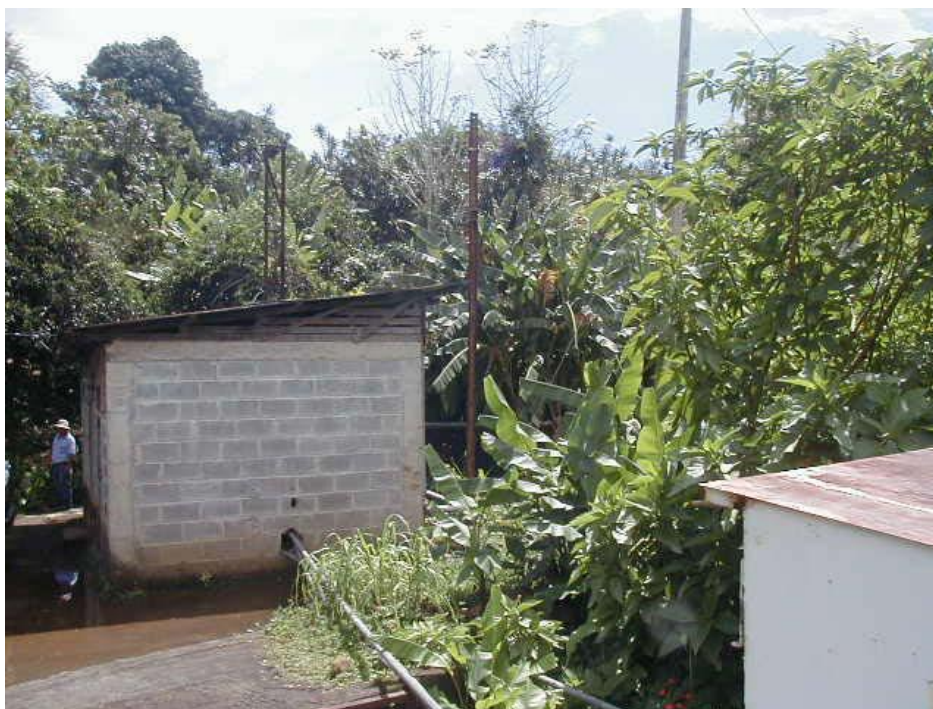
Estación de Bombeo Patal
