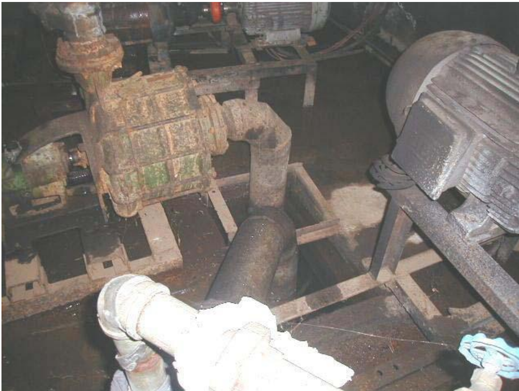
Ausencia de mantenimiento preventivo bombas y motores
