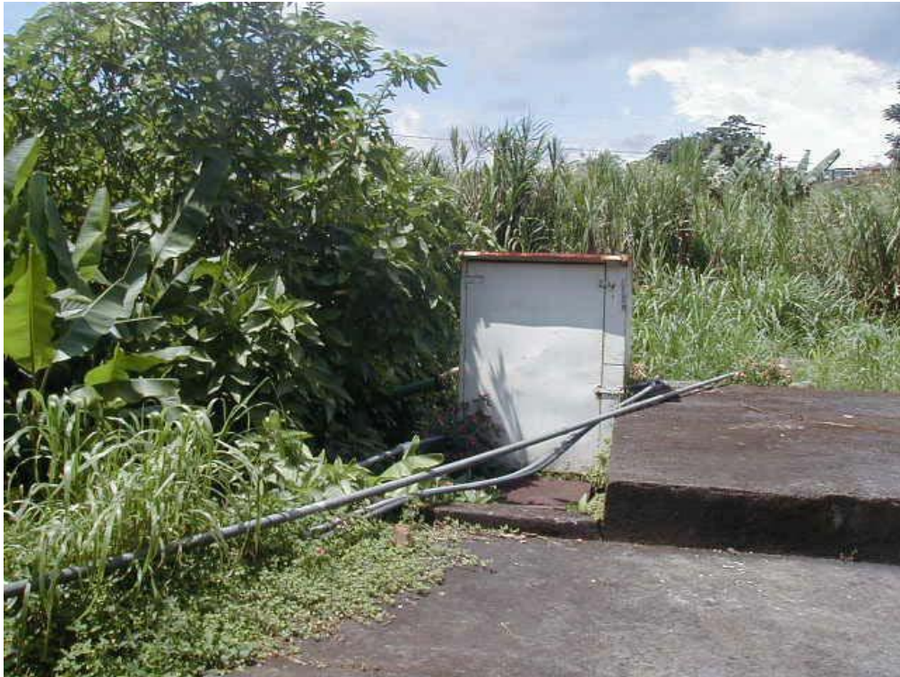
Estación de Bombeo Urbanización Esmeralda y Nueva Esparta
