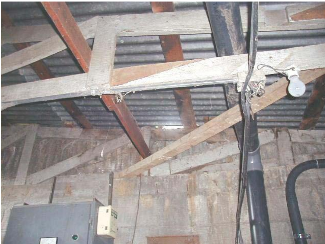
Necesidad de mejoramiento de infraestructura
