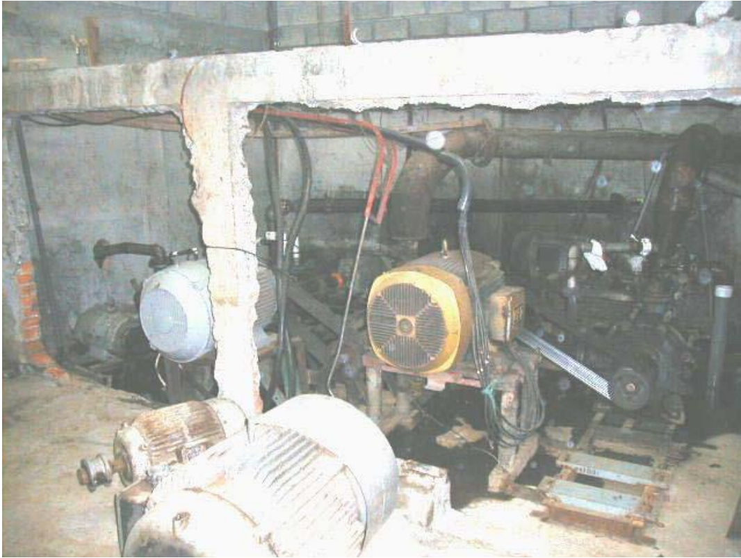
Conexiones eléctricas a los motores
